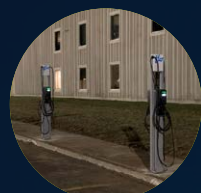
Installations de chargeurs de VÉ sur les propriétés d'Aecon
